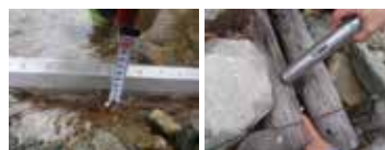
経年変化調査の状況(施工から4年後) ①摩耗量調査: 230箇所測定 → 局所的に摩耗が見られるが、施設の機能に影響なし。 ②腐朽量調査: 198箇所測定 → ビロテン平均貫入量17.5mmであり、殆ど腐朽なし。
