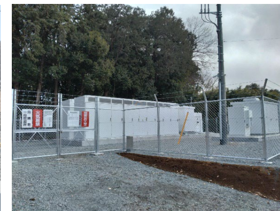
埼玉県日高市における蓄電所
