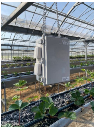
環境制御センターボックス
