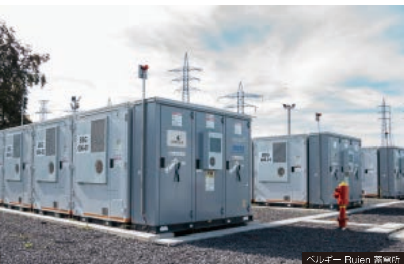
ベルギー Ruien 蓄電所
