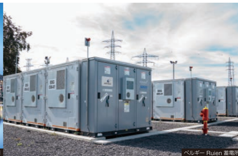
ベルギー Ruien 蓄電所
